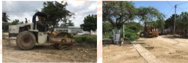
Pie de foto: Gestionamos el préstamo de motoniveladora y vibro compactador con CICON para adecuación de calle principal Tierra Baja.
